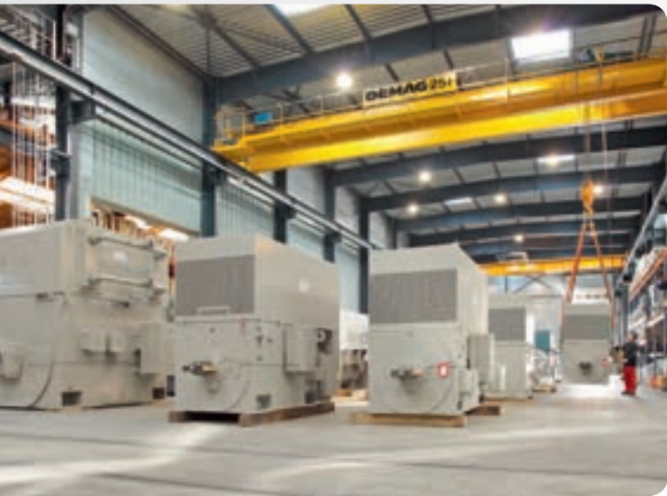
Almacén HELMKE para motores de alta tensión en Pulversheim, Francia
