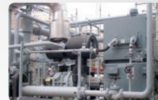
Compresor helicoidal - DWK 630-04, 1700 kW, 660 V, 120 Hz, 4 polos, IM B3, IP 55, IC 86W - Convertidor (NSFU S800-xx/1700 kW) - Transformador de resina (DGH 2000/7,2, 2000 kVA, 6 kV)
